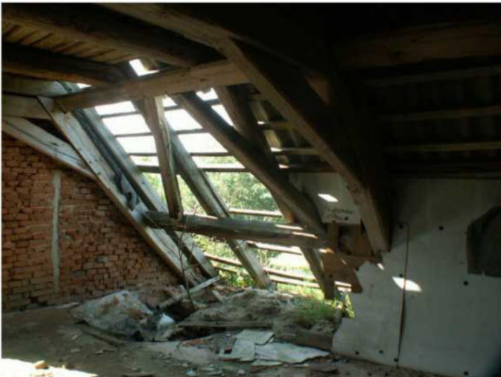
Statické poruchy krovu a trámového stropu
